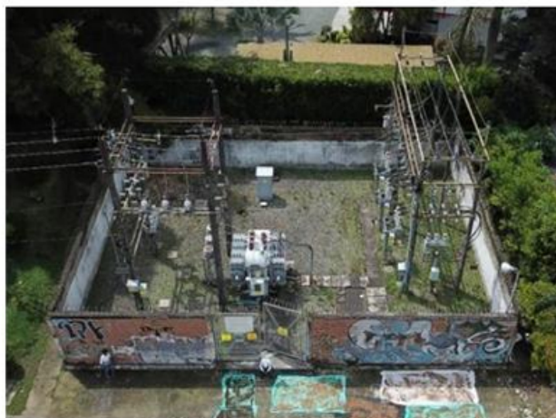
*Vista aérea Subestación Campestre (Dosquebradas – Risaralda)
