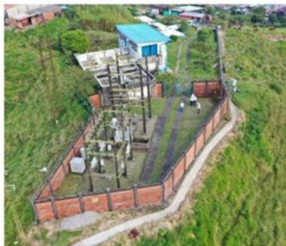
*Vista aérea Subestación Samaná (Samaná – Caldas)
