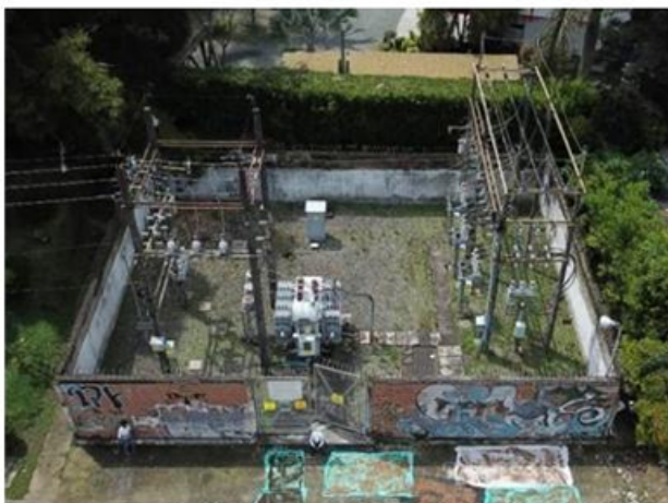
*Vista aérea Subestación Campestre (Dosquebradas – Risaralda)
